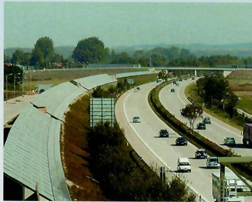
Bild 4: Integrationsmodell Photovoltaik-Lärmschutzwand in Freising (Foto: R. Kohlhauser GmbH)
